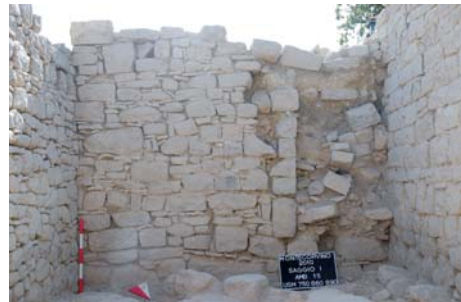
Fig. 20 – La porta di accesso all'amb. 15, occlusa da un crollo nella parte bassa e tamponata nella parte alta. Vista da Est.
